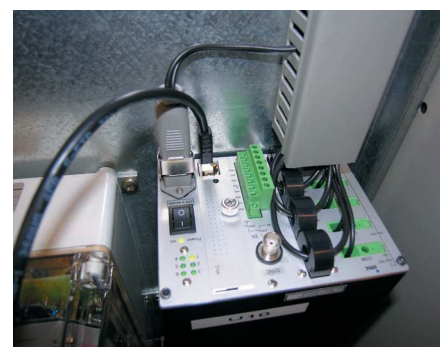
Bild 1. iMeax P1000 in einer Niederspannungshauptverteilung
